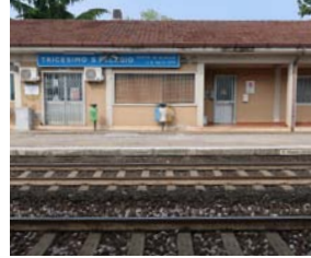
Mancanza adeguamento banchine
