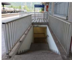
Assenza scivoli in sottopasso
