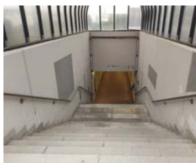
Assenza scivolo in sottopasso
