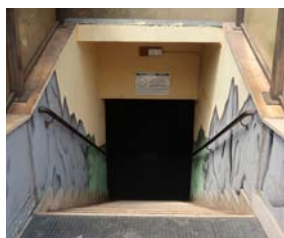
Assenza di rampe e scivoli in sottopasso
