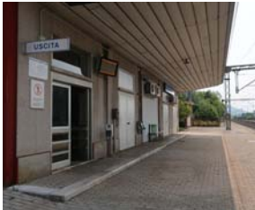
Assenza adeguata accessibilità edificio stazione-banchina 1
