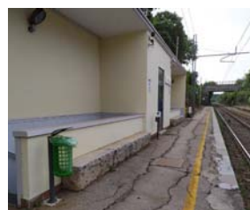
Mancanza adeguamento banchine
