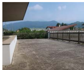
Mancata accessibilità strada-banchina 1
