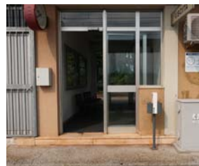
Mancanza accessibilità edificio stazione-banchina n.1
