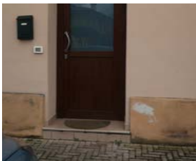
Mancata accessibilità strada-edificio stazione
