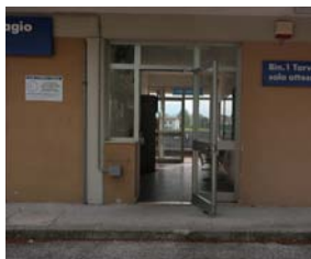
Mancata accessibilità strada-edificio stazione
