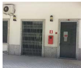
Mancanza accessibilità edificio
