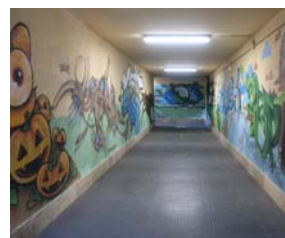
Assenza di rampe e scivoli in sottopasso
