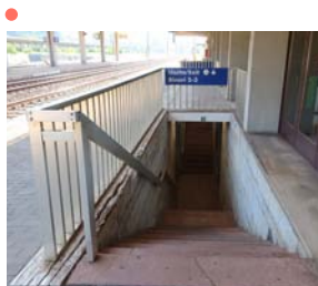
Assenza sistemi che garantiscano l'accessibilità tra le banchine
