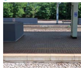
Mancato adeguamento banchine
