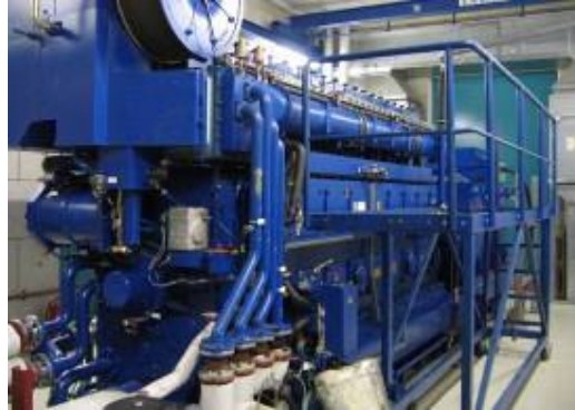
Figura 13 - Esempio di cogeneratore ad olio vegetale
