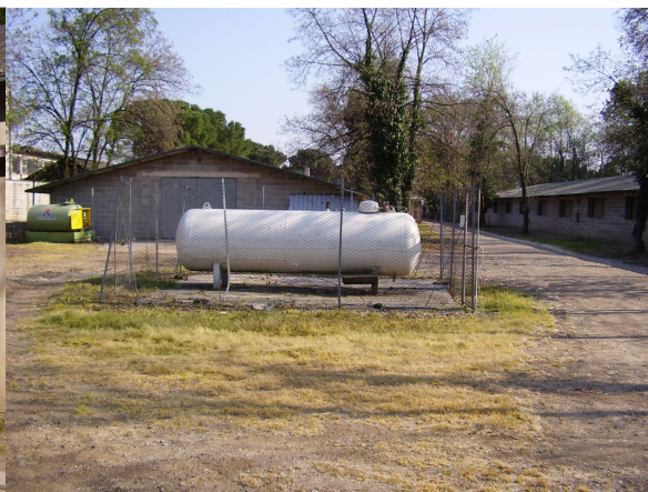
LATO NORD CAPP. n. 1 BOMBOLONE GAS (PART.)
