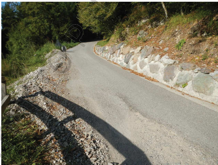
F6) Sezz. 9-10: scogliera e cunetta in c.a. esistenti, monte viabilità principale, da demolire.
