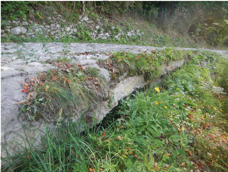
F8) Scavernatura evidente sezz. C-E – viabilità di accesso ex convento.
